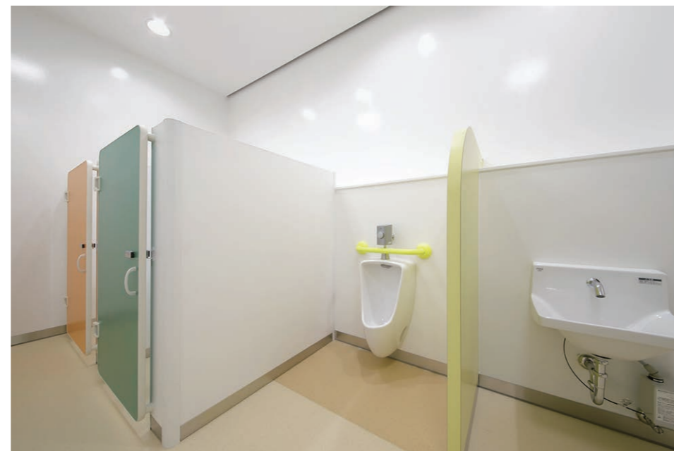
2F キッズトイレ 幼児用小便器、洗面器
