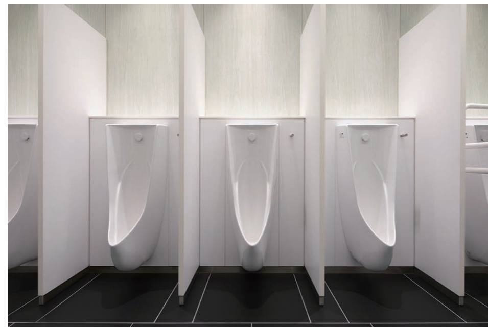
男性用トイレ 小便器
