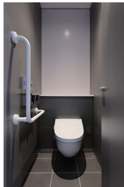
基準階 男性用トイレ 大便器
