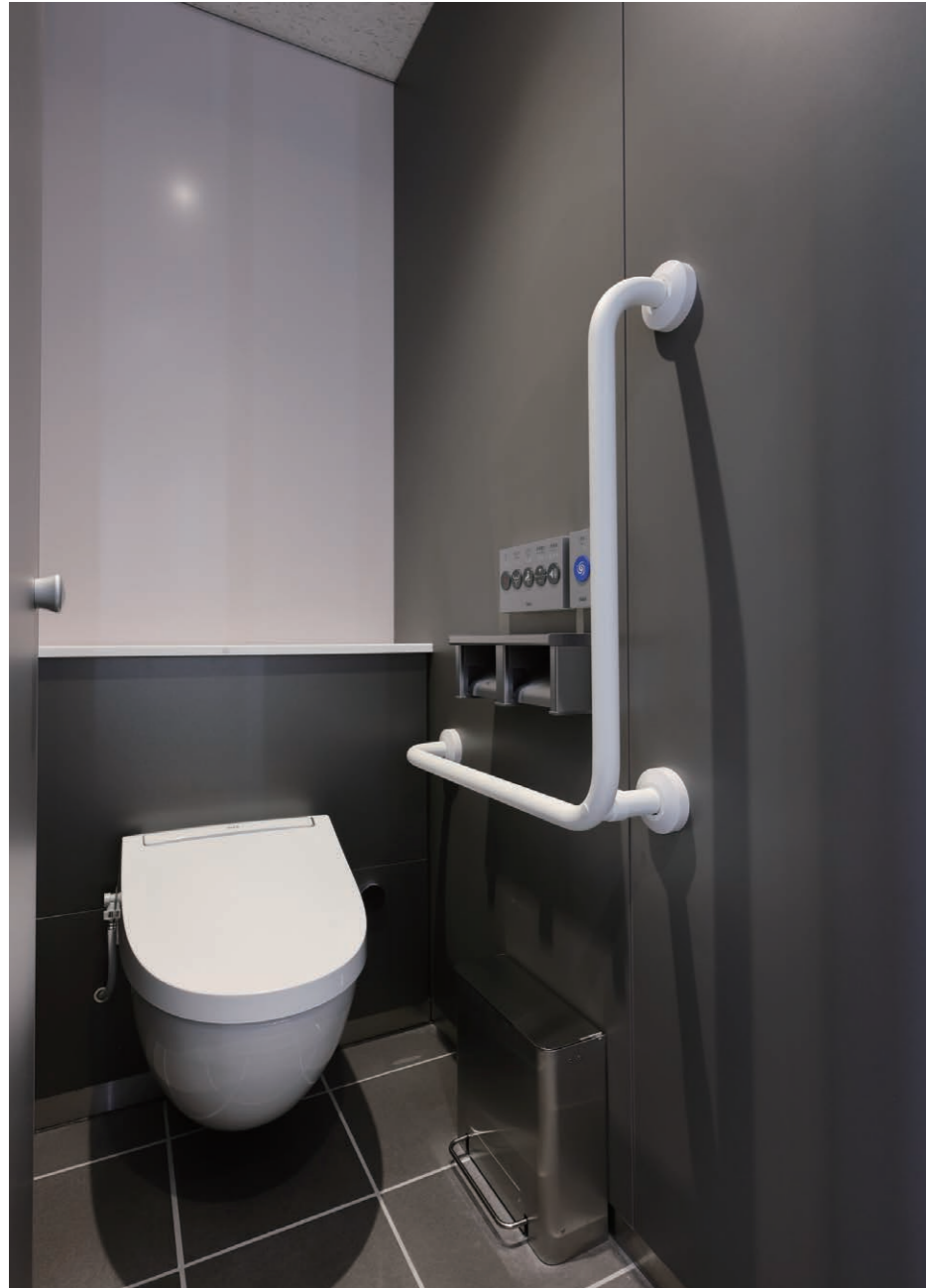
基準階 女性用トイレ 大便器
