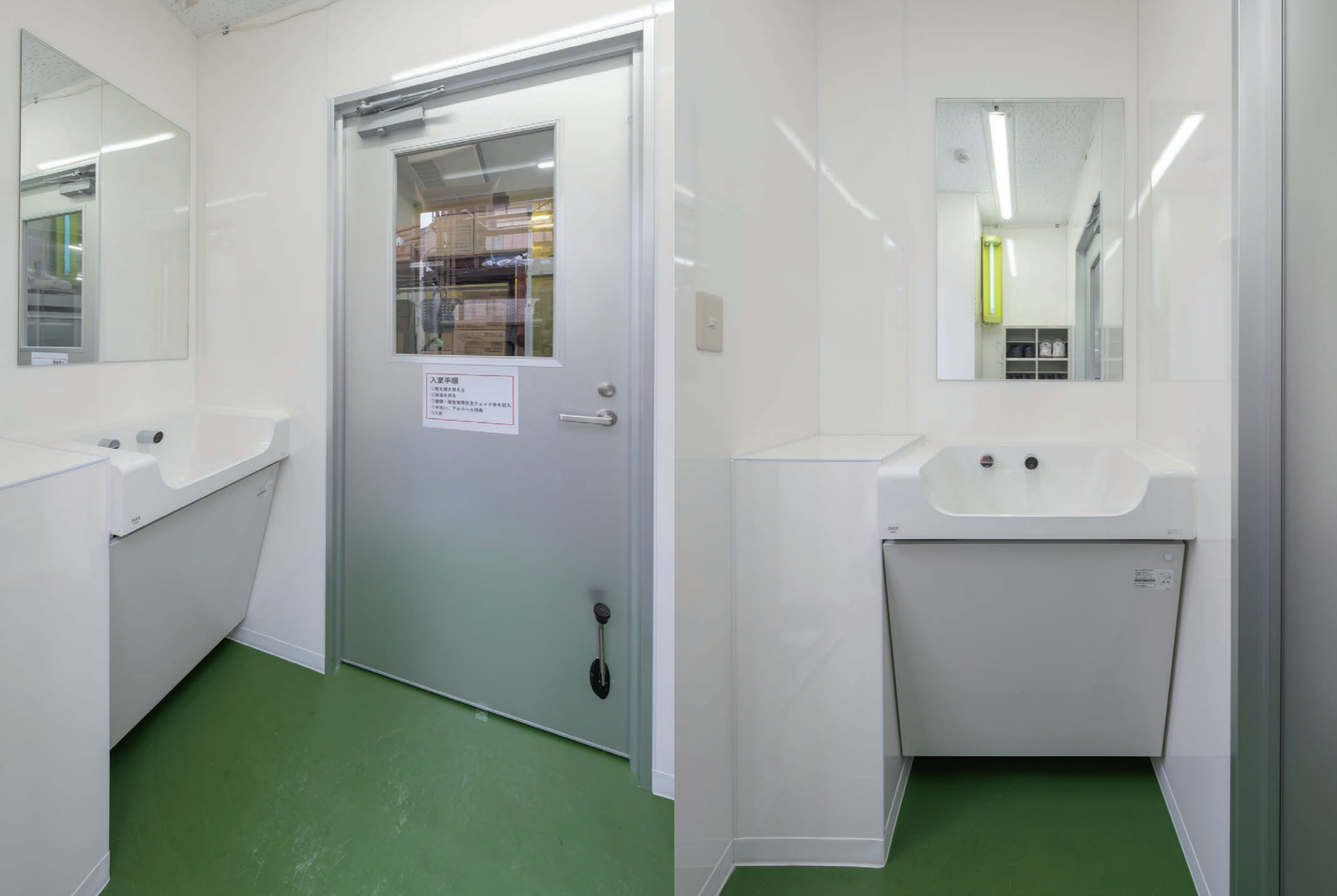
従業員用玄関 洗面器
