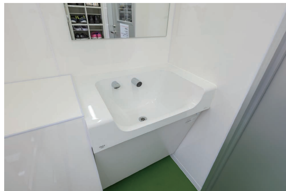
従業員用玄関 洗面器
