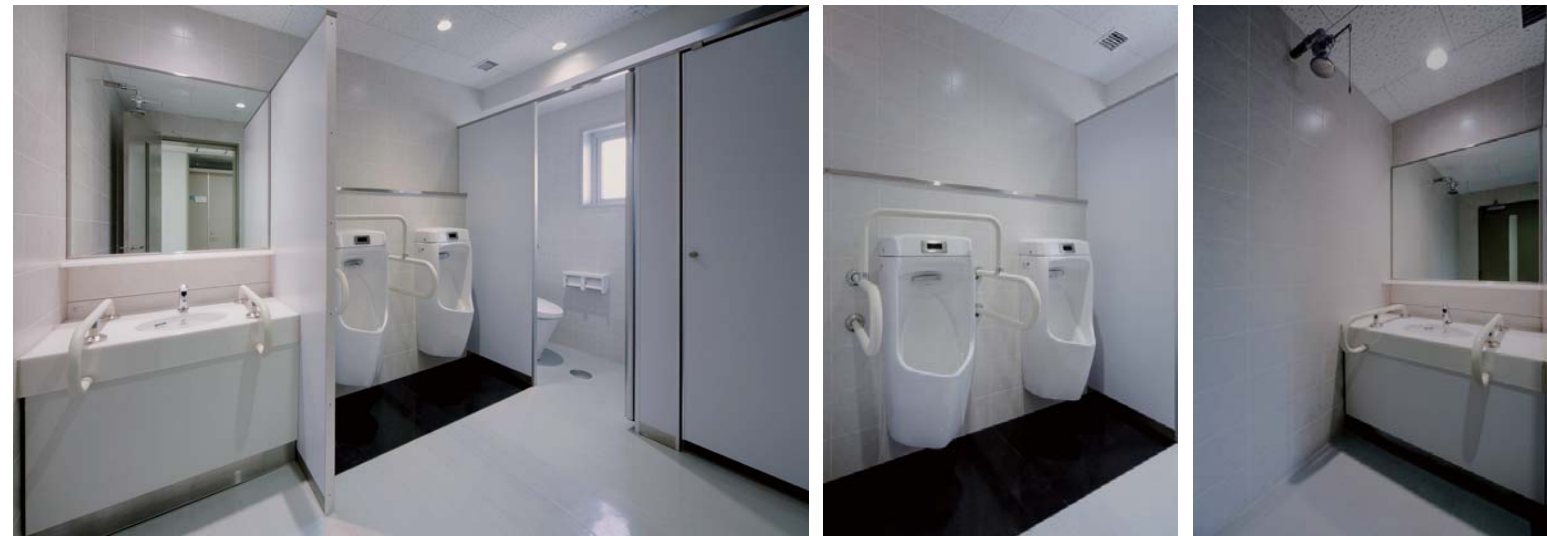
小便器には使用状態にあわせて自動で必要最低限の洗浄水量を流すスーパーAI節水機能搭載のものを、自動水栓にも節水性の高いスプレータイプを採用し、節水性の高いトイレへ。
