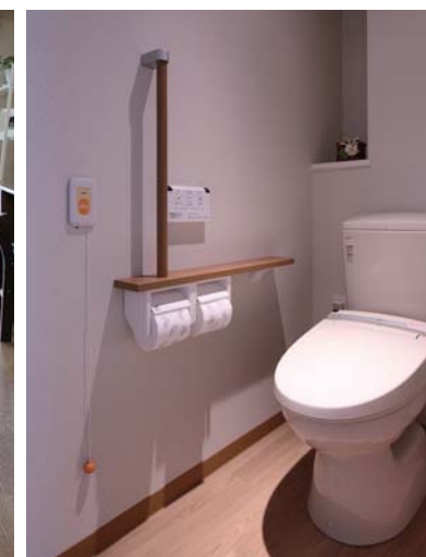
4階 居室トイレ
