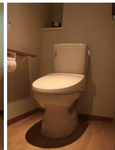
3階 居室トイレ
