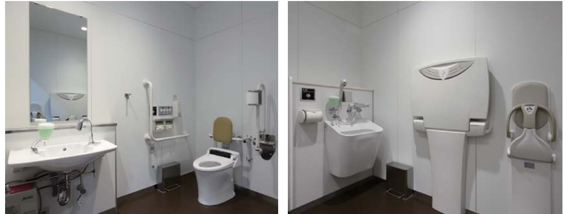
様々な利用者に配慮してオストメイト流しやベビーキープ・ベビーベットも設置。
