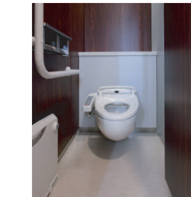
大便器ブース / チェンジングボード
