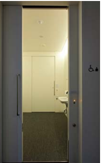
男性側と女性側の2方向から入室が可能な多目的トイレ。
