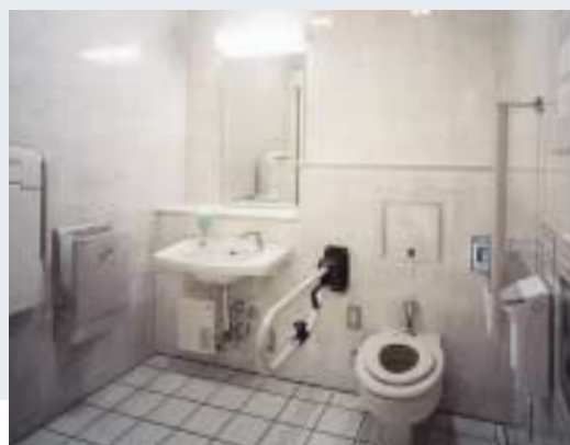
多目的トイレ ●INAX使用商品●大便器：C-25PU、洗面器：L-275他
