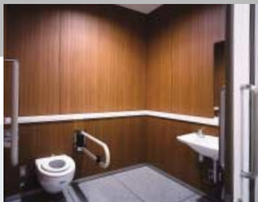
1階多目的トイレ ●INAX使用商品●大便器：HU-C22PURC-TS、洗面器：HU-L275AM
